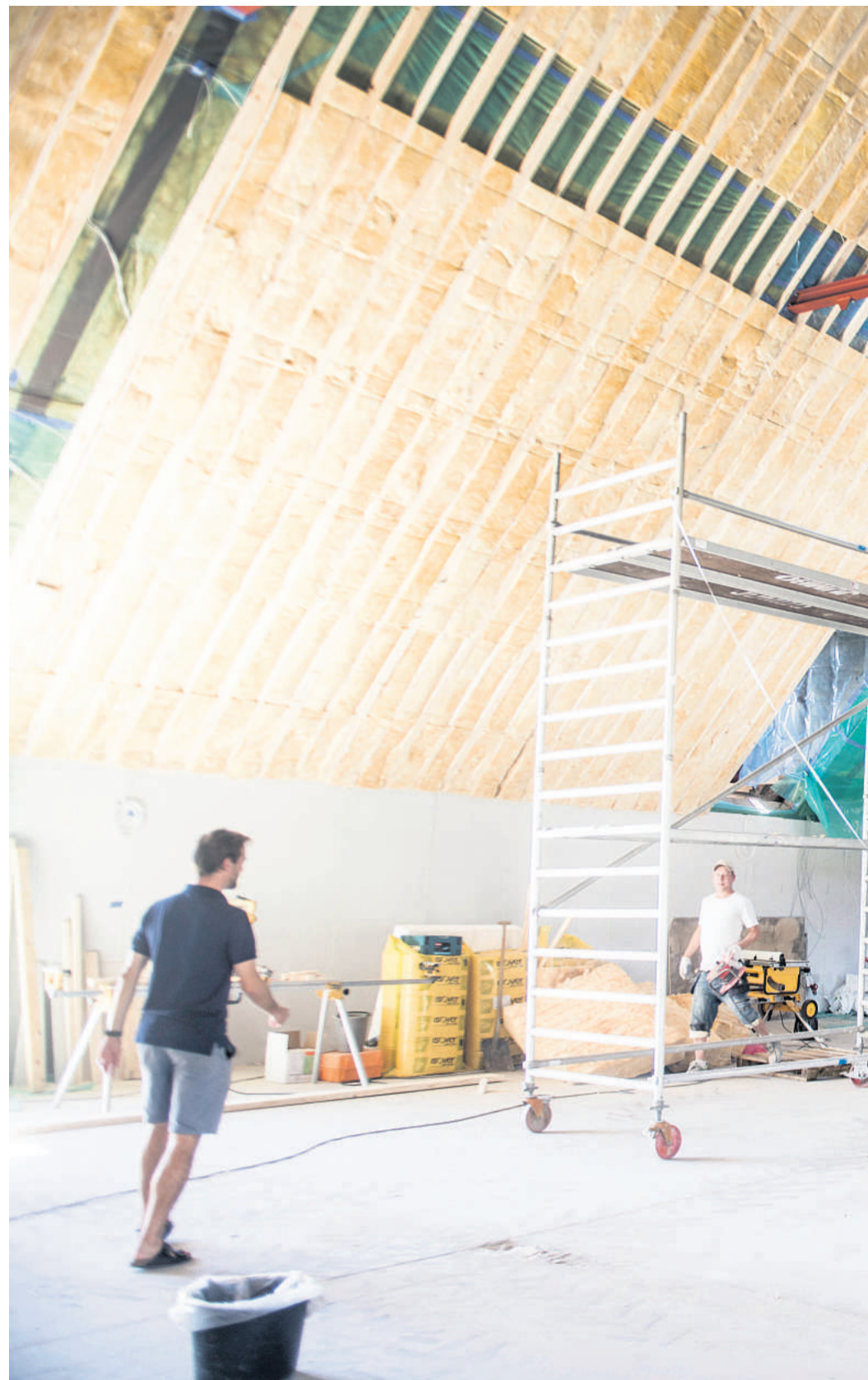
★ Håndværkerne arbejder på højtryk i den gamle ladebygning på Boltinggaard Gods. Laden skal ombygges til filmstudie. Godsejeren Peter-Vilhelm Rosenstand satser nemlig hårdt på at tiltrække filmbranchen som gæster, når de filmer på Fyn.
